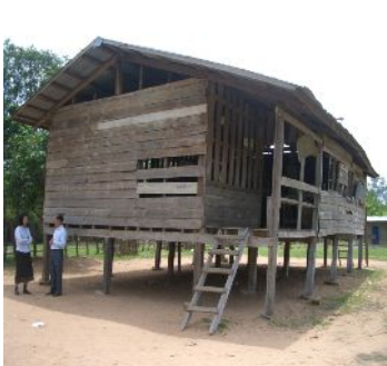
老朽化した校舎
