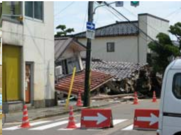
倒壊した家屋
